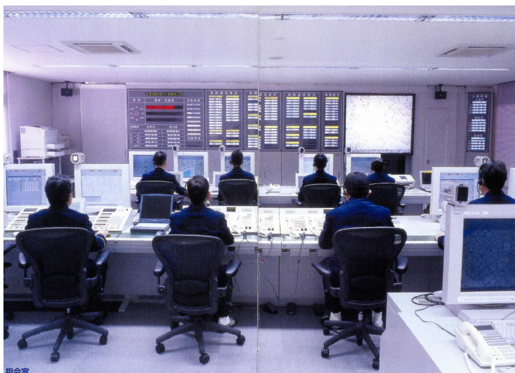
(消防指令センター)
